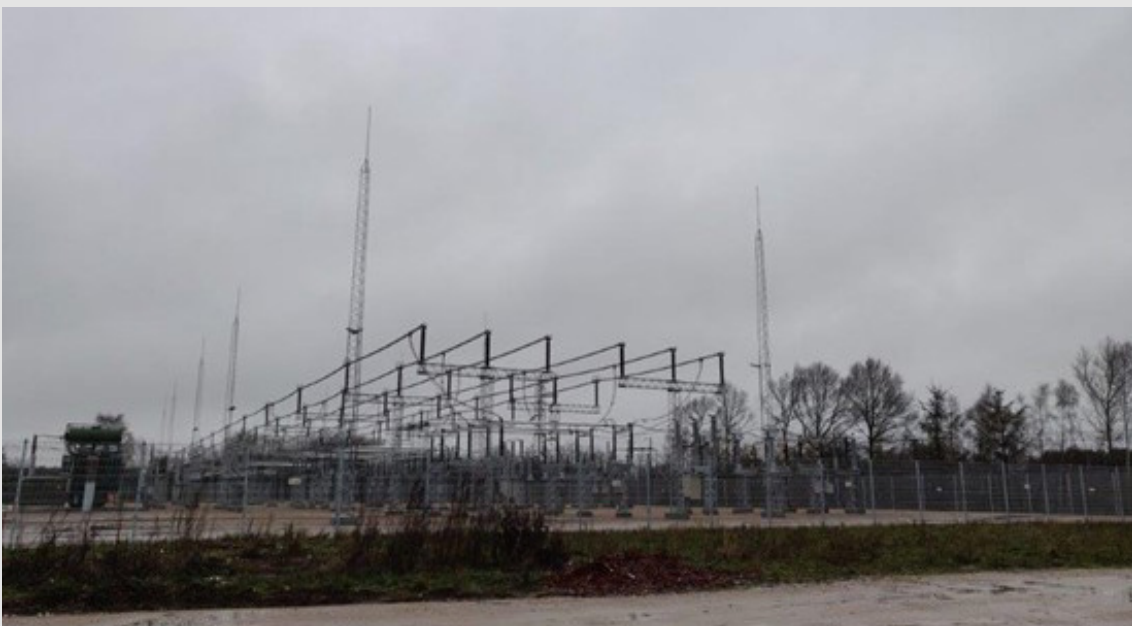
Eksempel på en højspændingsstation. Her 132 kV station Ringsted, som er uden egentligt beplantningsbælte. 132 kV højspændingsstationer svarer i opbygning til 150 kV stationer.
